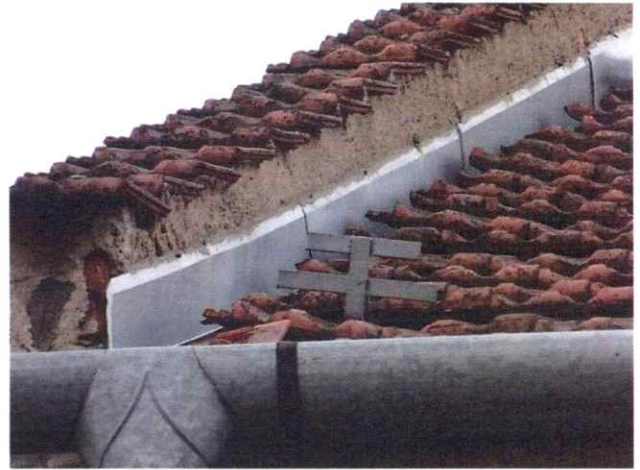
foto /4/ Poškozená krytina v místě sněhového zachytače
