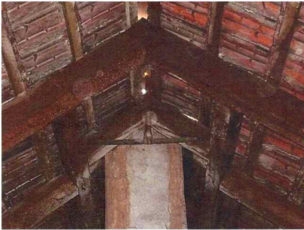
foto /3/ Absence doplňkové hydroizolační vrstvy
