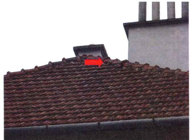
foto /8/ Netěsnosti v místě nároží
