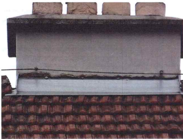
foto /9/ Netěsnosti v místě komínového tělesa
