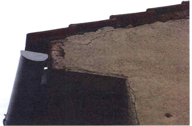
foto /10/ Poškozená omítka v místě římsy
