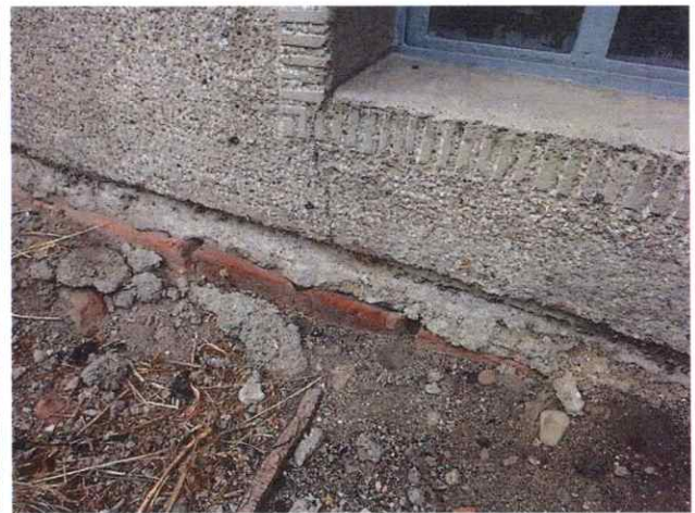
foto /18/ Absence hydroizolace spodní stavby
