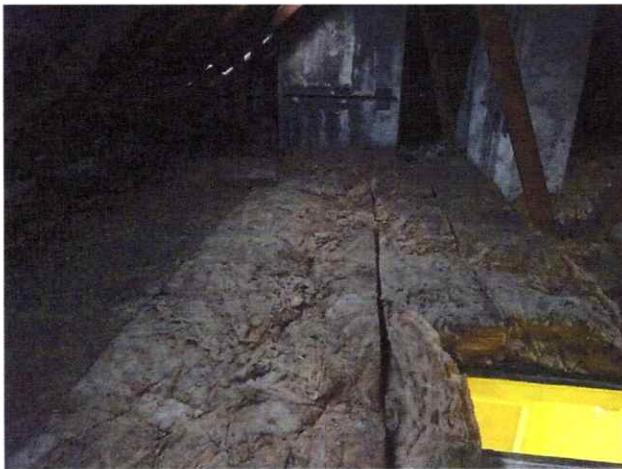
foto /5/ Poškozená tepelná izolace
