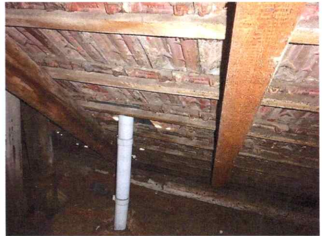
foto /6/ Netěsnosti v místě prostupujícího potrubí odvětrání kanalizace
