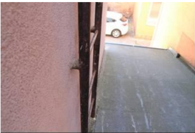
foto /10/ Malá vodorovná vzdálenost konstrukce žebříku na střechu od stěny, do které je kotven.
