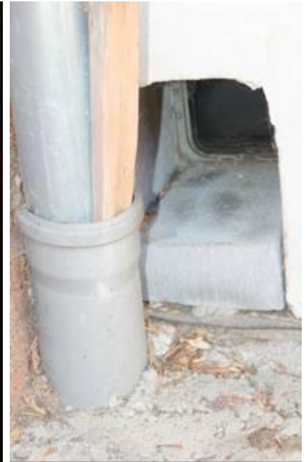
foto /58/ Nedostatečného přístupu k uzavěru vody do bytu ve dvorním traktu, zároveň tepelný most
