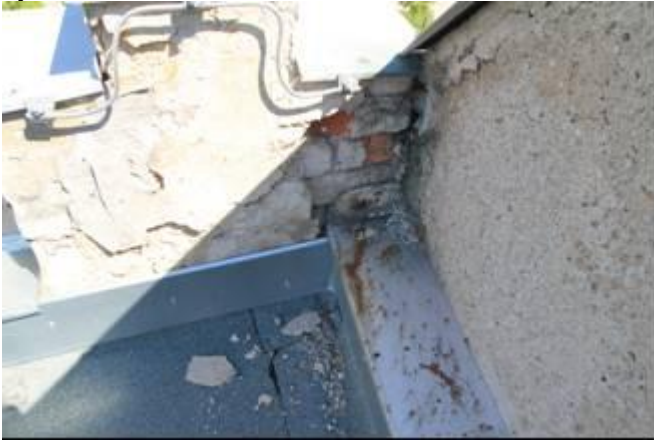
foto /9/ Netěsnosti mezi krycí (oplechování) a stavební konstrukcí.
