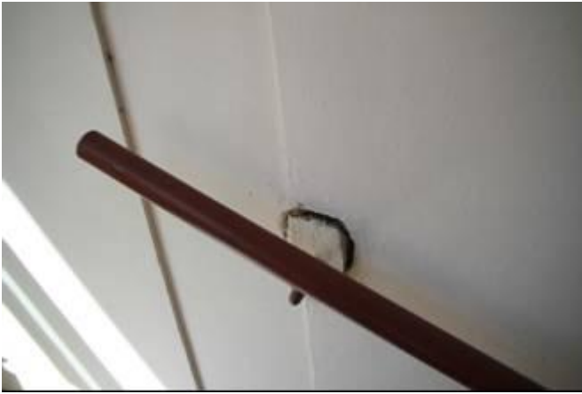
foto /46/ Uchycení zábradlí schodiště je uvolněné.
