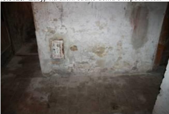
foto /30/ V suterénu byly zjištěny masivní vlhkostní poruchy.
