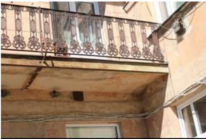
foto /50/ Zatékání do balkonu nevhodnými detaily a degradovanou hydroizolací.
