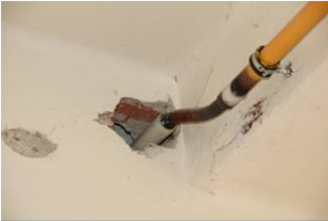
foto /64/ Zřetelné nedávné zásahy do rozvodů bez možnosti ověření platné revize.
