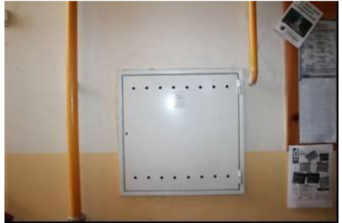
foto /65/ Hlavní uzávěry plynu pro jednotlivé byty nejsou označeny.
