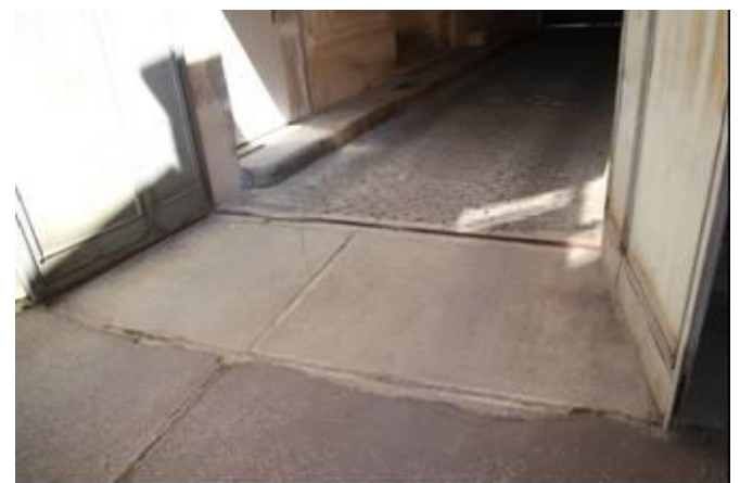
foto /40/ Dům se sníženým vjezdem do průjezdu - při přivalových deštích může zatékat voda a dochází vlhnutí základových konstrukcí a sklepních prostor, případně průjezdu
