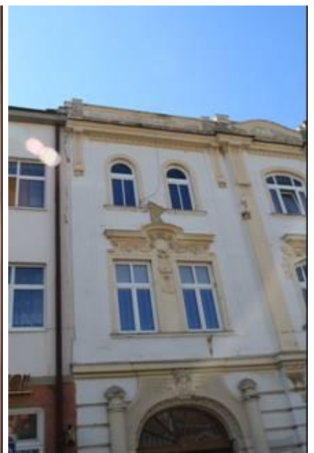
foto /35/ Odpadávající omítka nad vstupem
