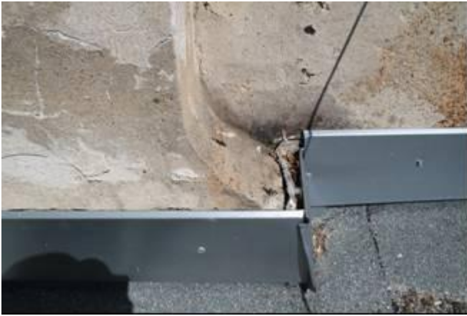
foto /7/ Netěsná spára mezi okrajem svislé hydroizolace a stěnou
