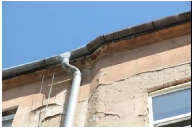
foto /16/ zatékání do fasád s omítkou vadnými klempířskými konstrukcemi
