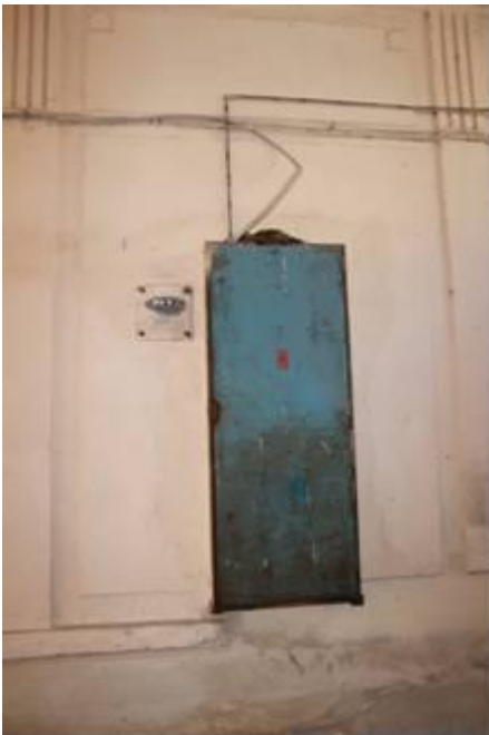
foto /54/ Napojení vedlejšího domu z rozvaděče umístěného v průjezdu bytového domu.
