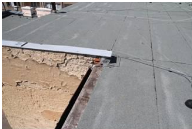
foto /14/ Netěsnosti mezi krycí (oplechování) a stavební konstrukcí.
