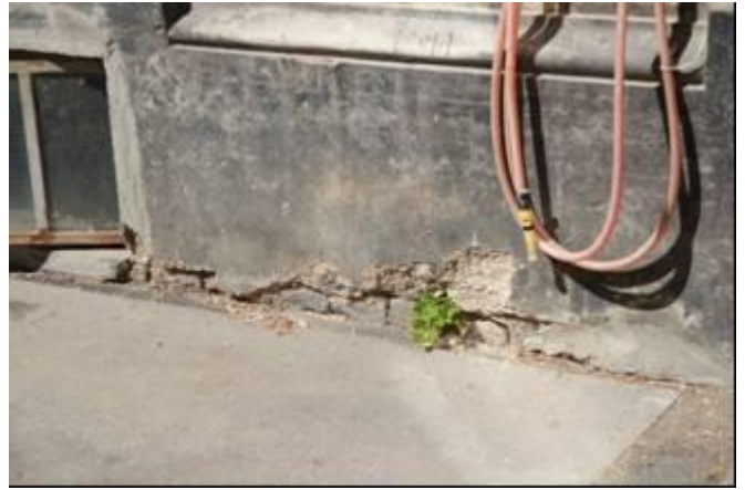
foto /28/ Degradace zdiva vlivem vlhnutí
