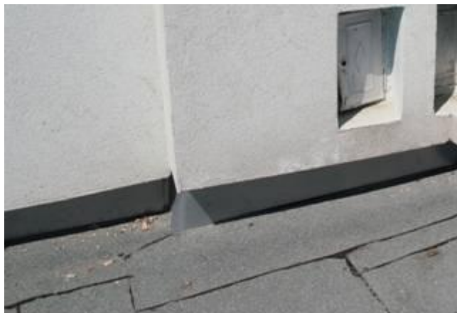
foto /2/ Nápojení hydroizolace ploché střechy na související konstrukce provedeno plechovým lemováním
