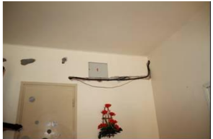
foto /55/ Nedávné zásahy do rozvodů elektro bez možnosti ověření, zda byly zohledněny v platné revizi.
