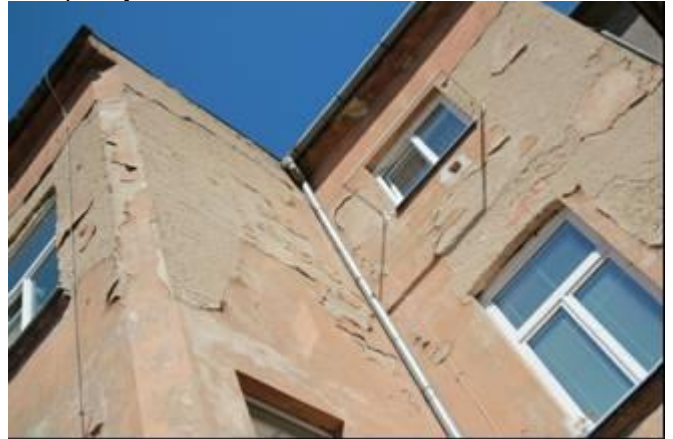
foto /18/ Degradace omítek fasády
