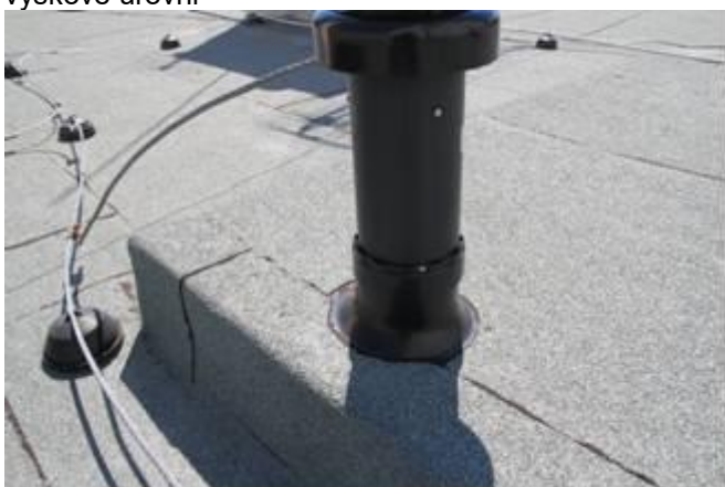
foto /3/ Detail nápojení na plechové prvky - nízká svislá část hydroizolace v nápojení na související konstrukce vystupující nad plochou střechu
