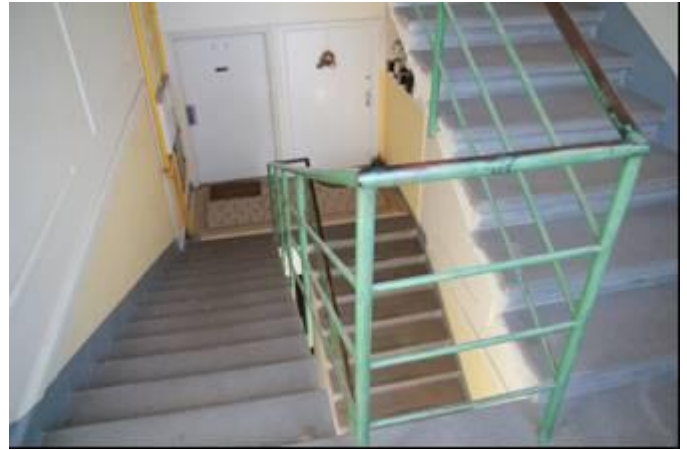
foto /47/ Nevyhovující zábradlí – vodorovné příčky. Podlaha podesty schodiště není dilatována od navazujících stěn, hrozí riziko šíření kročejového hluku. Mechanické poškození povrchu zábradlí
