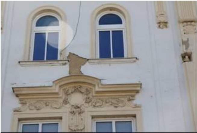
foto /22/ Degradace omítek fasády
