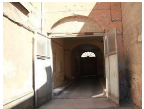
foto /42/ Průjezd není zateplen, ochlazuje byty nad průjezdem.
