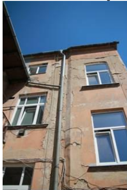
foto /20/ Degradace omítek fasády
