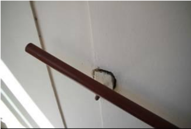
foto /36/ Uchycení zábradlí schodiště je uvolněné.
