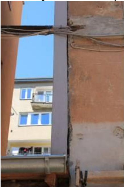
foto /19/ Obvodová konstrukce není až na 1 stěnu zateplena.
