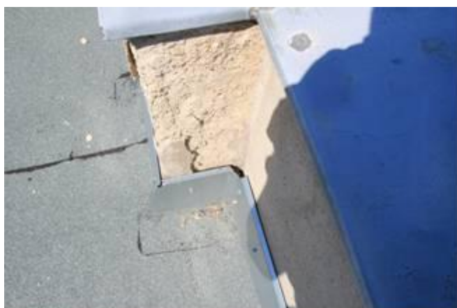
foto /6/ Netěsnosti mezi krycí (oplechování) a stavební konstrukcí.
