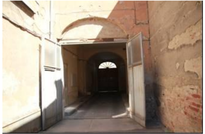
foto /37/ Nedostatečné denní osvětlení - průjezd osvětlen pouze nadsvětlíkem. Dodatečně zhotovený ocelový překlad – tepelný most, degradace povrchové úpravy (omítky)
