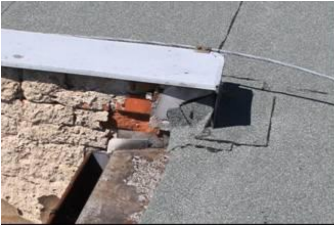
foto /15/ Netěsnosti mezi krycí (oplechování) a stavební konstrukcí.
