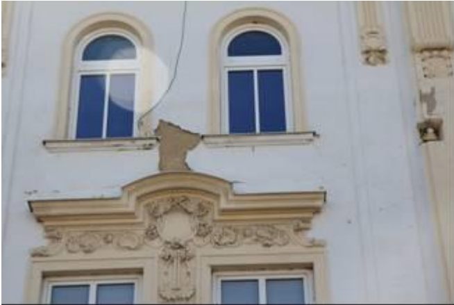
foto /17/ Degradace omítek fasády
