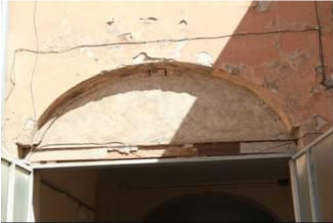
foto /31/ Trhliny v nenosných konstrukciách vyvolané deformáciami jiných konstrukcií
