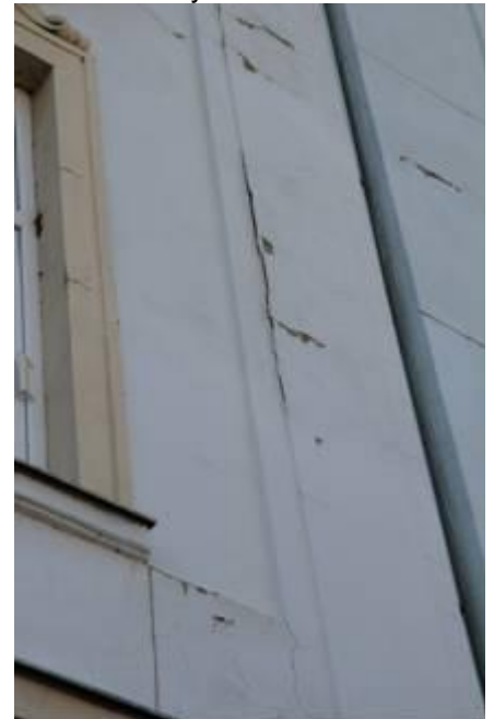
foto /21/ Degradace omítek fasády
