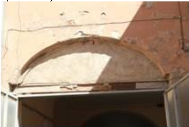
foto /43/ Objekt není zateplený, betonové překlady nad okny, nosník nad vraty průjezdu.
