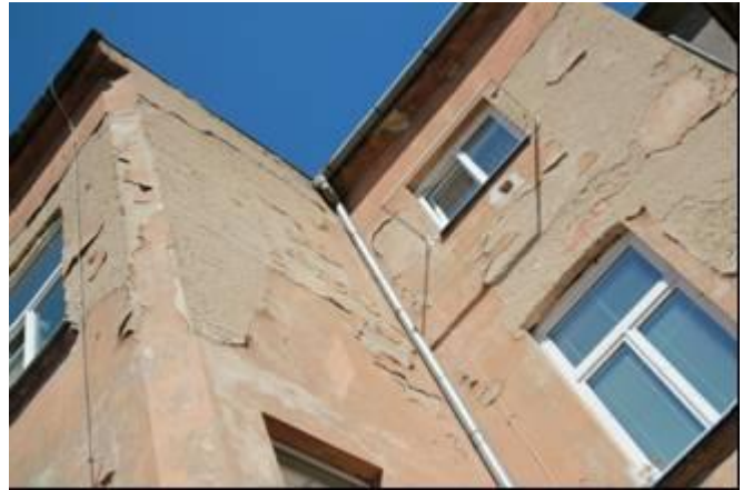
foto /23/ Degradace omítek fasády
